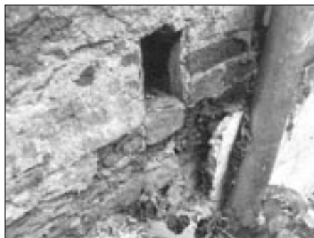
Destrukce zdiva na jihozápadní straně.
