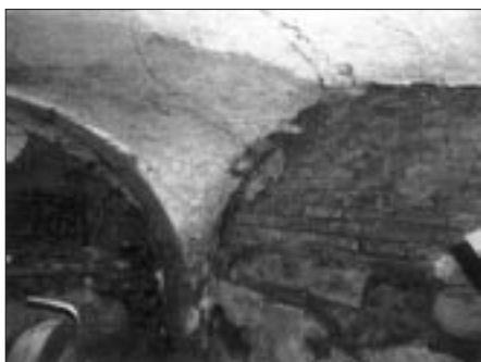
Zvlhčený interiér s rozpraskanými klenbami
