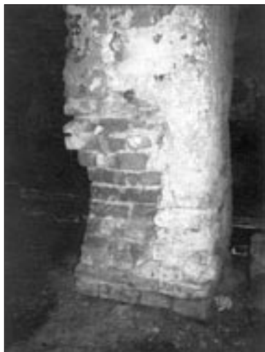
Jeden ze zničených pilířů držících cihlovou klenbu.
